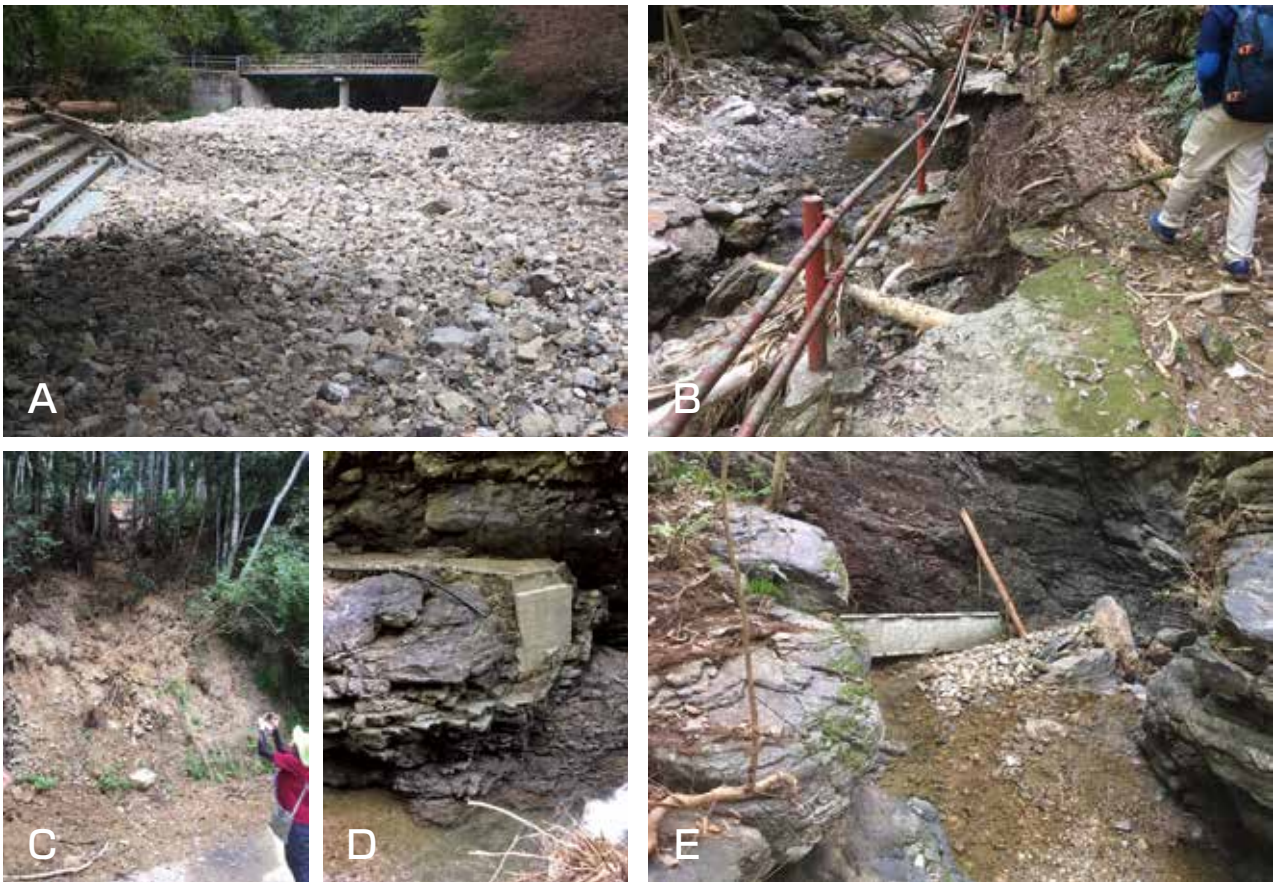
図8 豪雨による被害の跡 A：川底に土砂が堆積し、左側に見える石段は半分ほど埋まっている。B：遊歩道が崩落して手すりが宙吊りになっている。C：車道わきの斜面から土砂が流出した跡。D：橋が流されて遊歩道が寸断されている。E：画面中ほどに流された橋が横たわっている。
